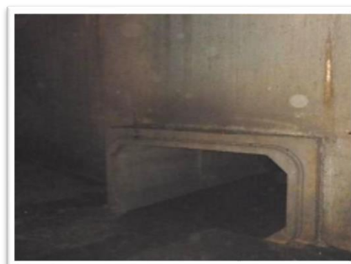
Bassin enterré Baffu à Dijon – arrivée effluent
