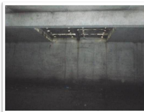
Bassin enterré Baffu à Dijon – accès
