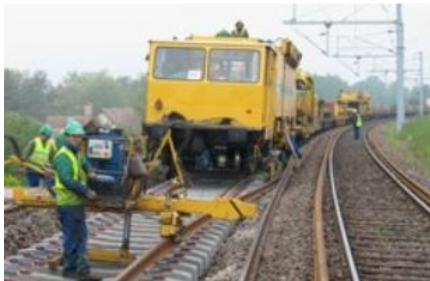
Longs Rails soudés sur traverses béton
