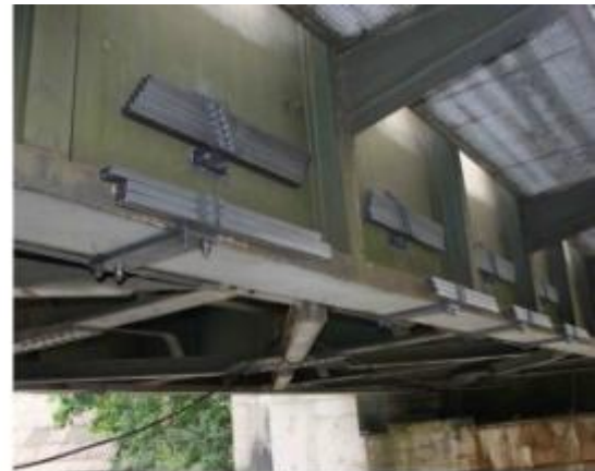
Absorbeur sur platelage
